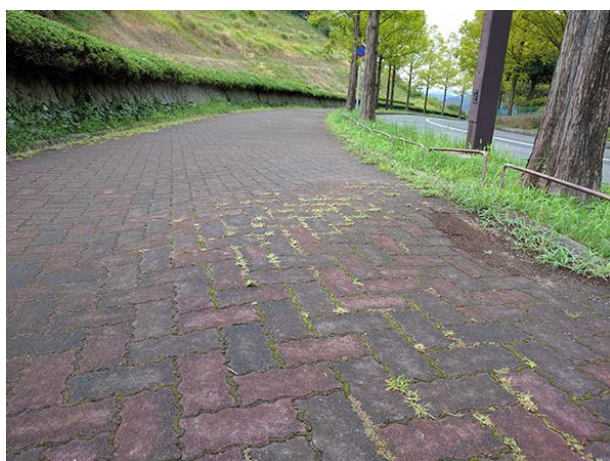
インターロッキングブロックの凸凹で 車いすなどの移動に支障あり
