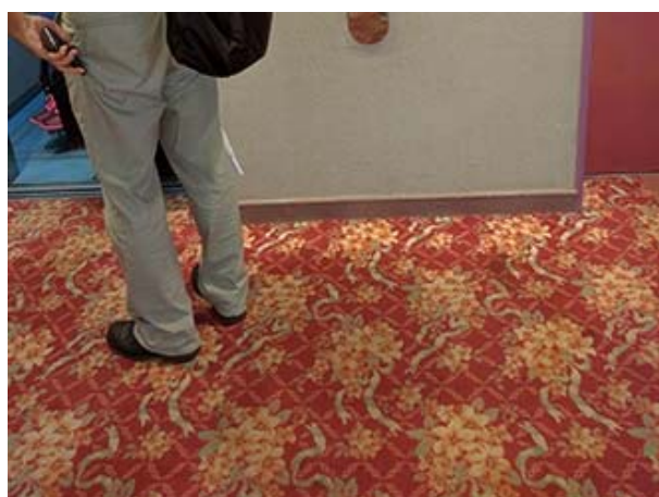
エレベーターへの視覚障がい者誘導ブロックの敷設がない
