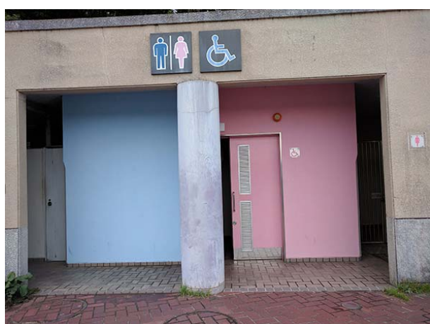
屋外トイレの設備が基準を満たしていない
