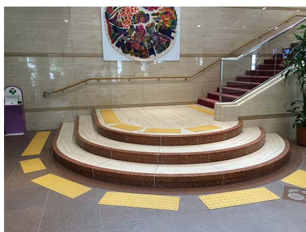
階段部の手すりが連続していない
